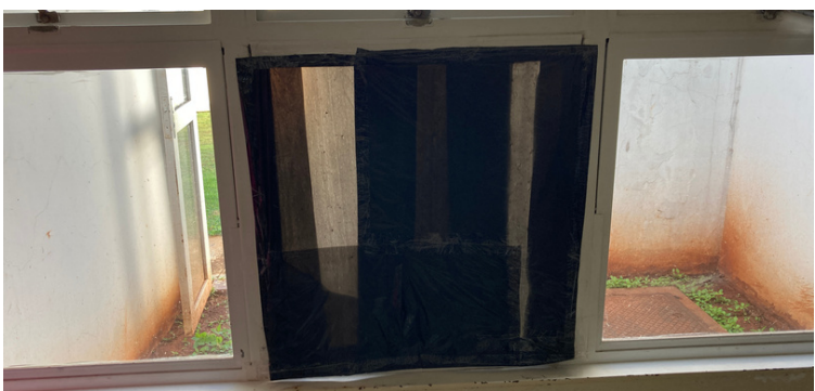
Foto 11 Janela com vidro quebrado na emergência infantil.
