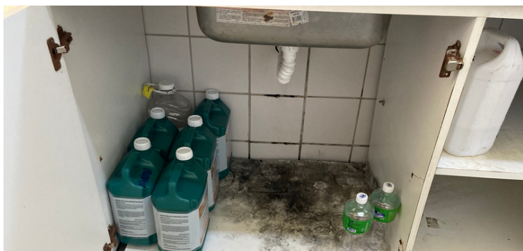
Foto 14 Mofo no armário causado por vazamento da pia.
