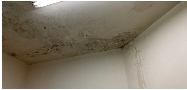
Foto 2 Teto da sala de hidratação após chuva forte no dia 15/05/2022.
