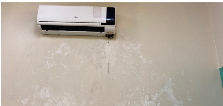
Foto 7 Infiltração na parede causada por vazamento do ar-condicionado.
