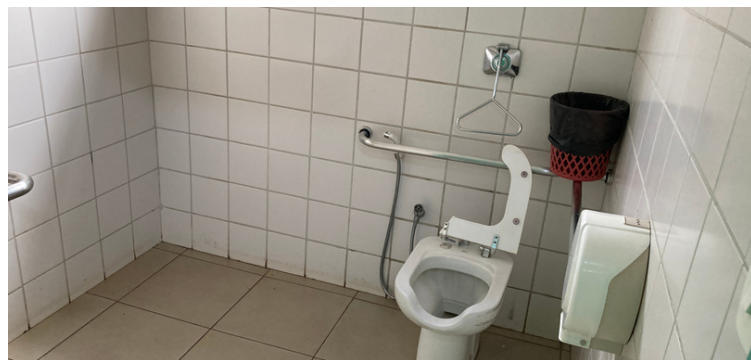
Foto 10 Tampa do vaso sanitário quebrada.
