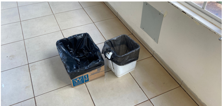
Foto 3 Baldes nos corredores para conter as goteiras do telhado.
