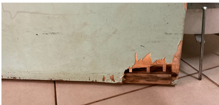
Foto 12 Portas das salas danificadas.
