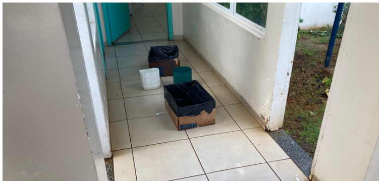
Foto 4 Várias caixas e baldes no corredor para armazenar água das goteiras.
