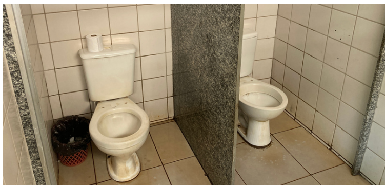
Foto 16 Falta de portas nos banheiros da recepção.
