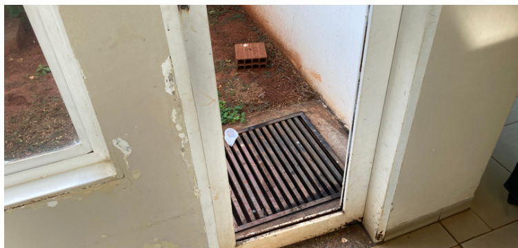
Foto 9 Falta de vidro nas portas.
