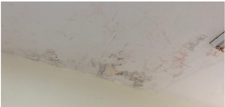
Foto 3 Infiltrações na recepção próximo a sala da odontologia.
