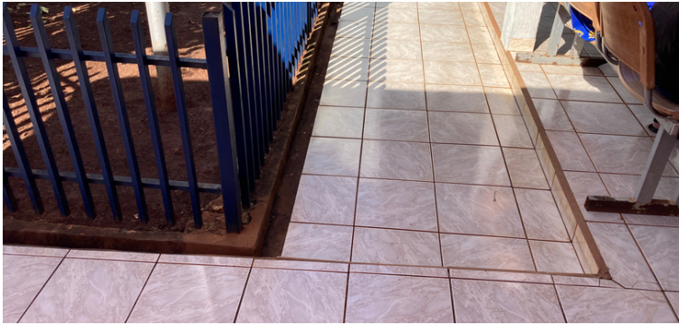
Foto 3 Piso da recepção é escorregadio, causa acidentes frequentes.
