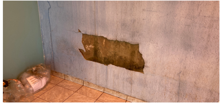
Foto 4 Pintura danificada e rachaduras na parede da recepção.
