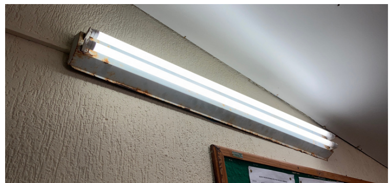
Foto 8 Luminária enferrujada na recepção.
