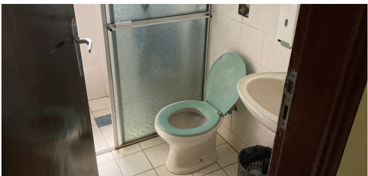
Foto 13 Banheiros não adaptados para pessoas com necessidades especiais.
