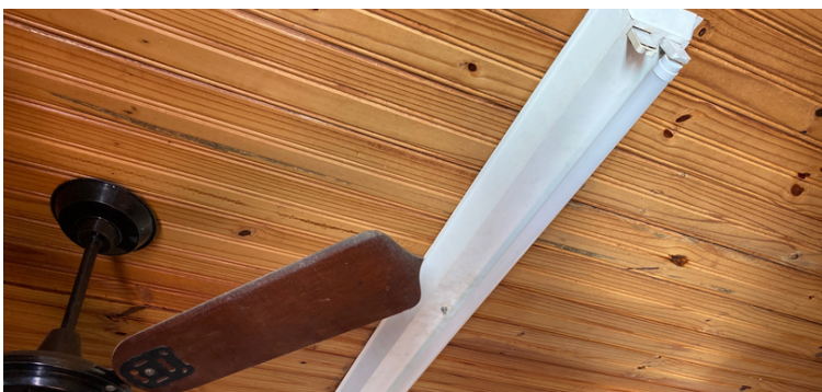
Foto 7 Luminária com falta de lâmpadas.
