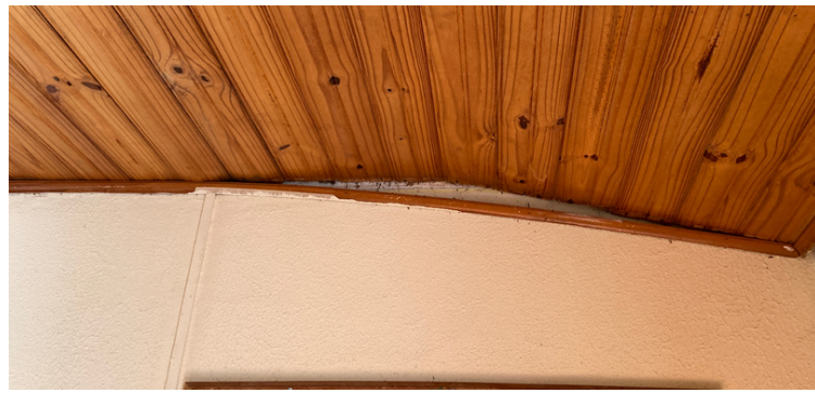
Foto 18 Forro de madeira na sala dos agentes comunitários empenado.
