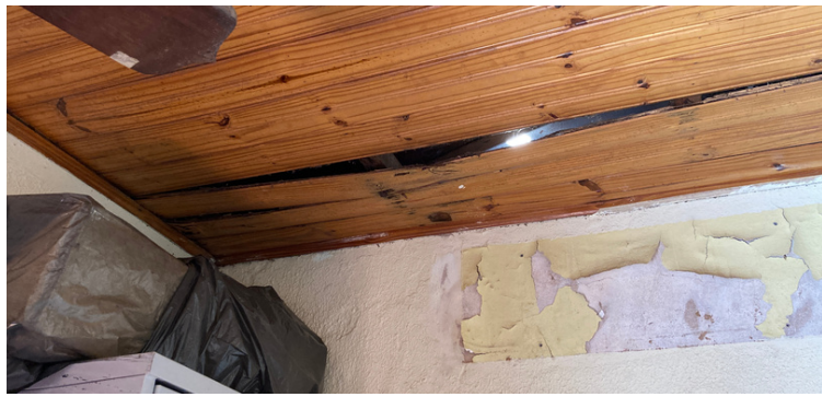
Foto 17 Forro de madeira está danificado e com risco de queda.
