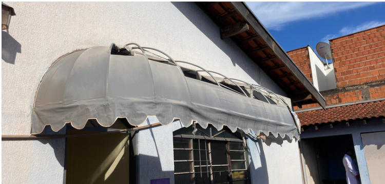
Foto 5 Toldo rasgado na janela da sala de vacinas.
