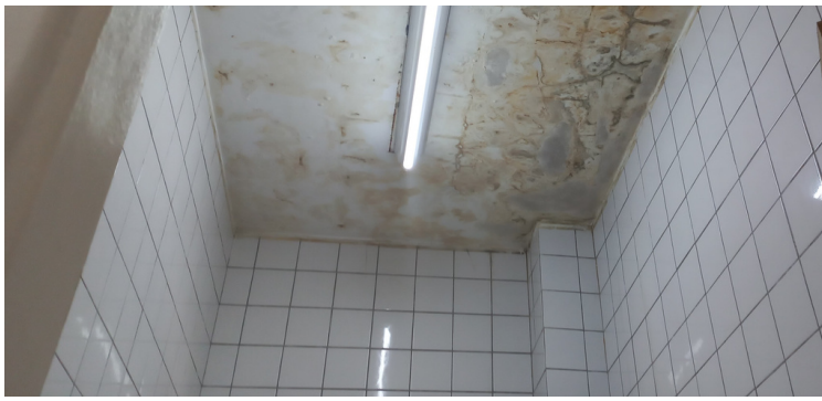
Foto 9 Banheiro masculino comprometido por consideráveis infiltrações.
