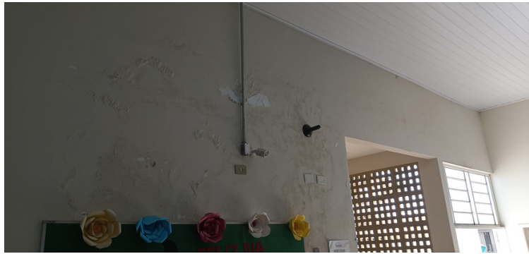
Foto 3 Recepção constante de infiltrações.
