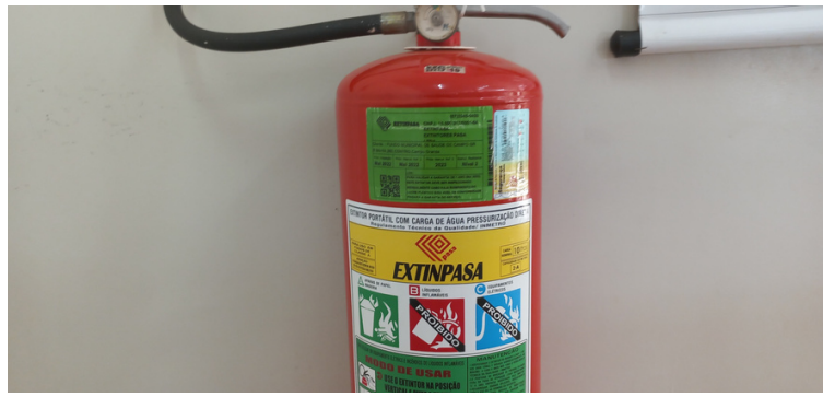
Foto 10 Extintores dentro da data de validade.
