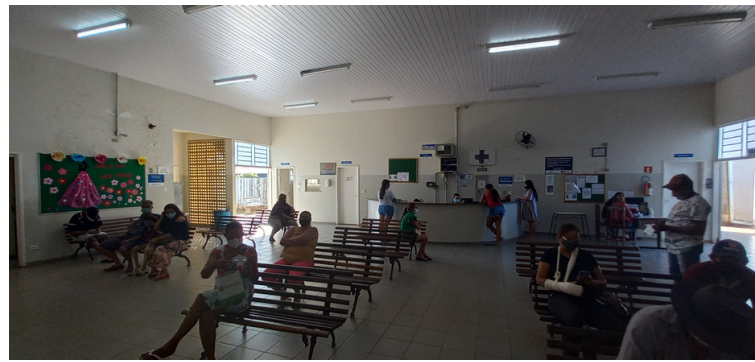
Foto 2 Recepção sem a devida climatização e lâmpadas sem funcionamento.
