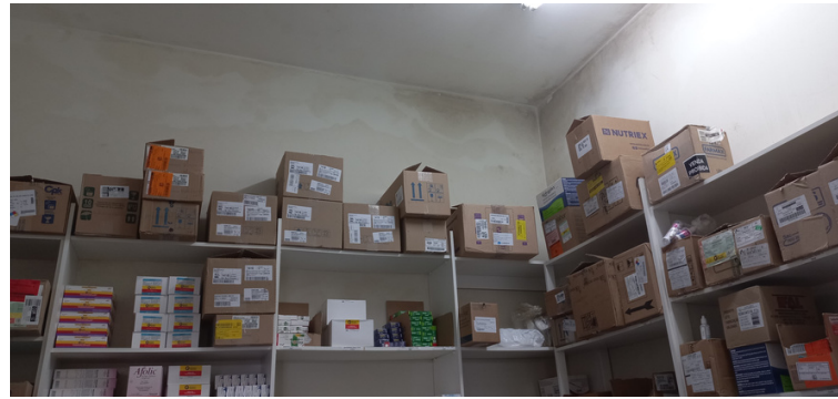
Foto 4 Farmácia bem provida, entretanto com presença de infiltração.
