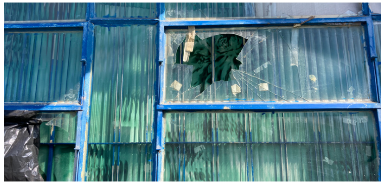
Foto 2 Janelas quebradas precisando serem substituídas.
