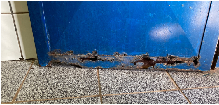
Foto 3 Portas consideravelmente corroídas pela ferrugem.
