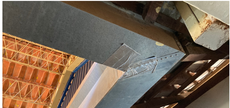
Foto 6 Calhas avariadas, necessitando de manutenção.
