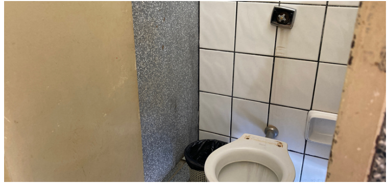
Foto 4 Vasos sanitários sem tampas e assentos, bem como precisão de conserto na hidra.
