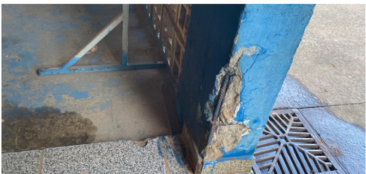
Foto 7 Rachaduras constantes em determinados locais da unidade.
