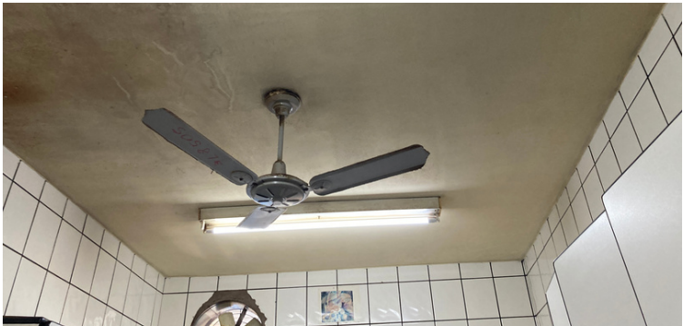
Foto 5 Teto da cozinha atingido por infiltração.
