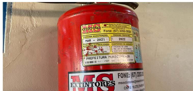
Foto 8 Extintores com a data de validade vencida.
