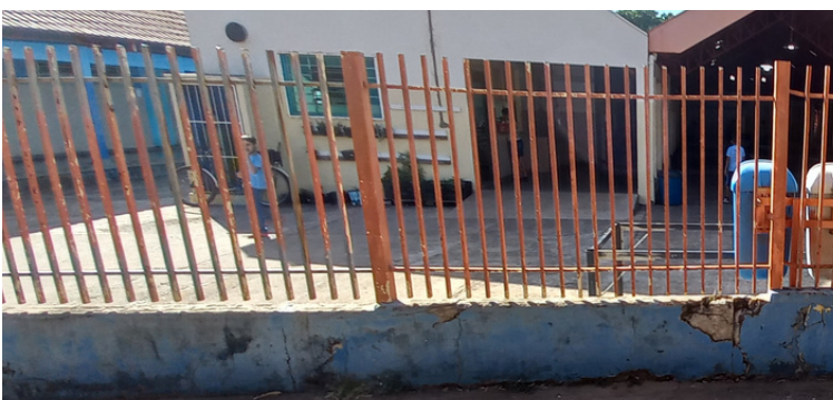
Foto 6 Grades com pintura desgastada.
