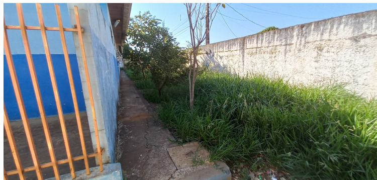
Foto 10 Mato alto nos arredores do prédio necessita de poda.
