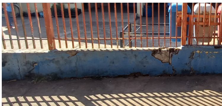
Foto 5 Muro com rachaduras na estrutura.
