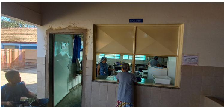
Foto 4 Fachada da cozinha necessita de pintura.
