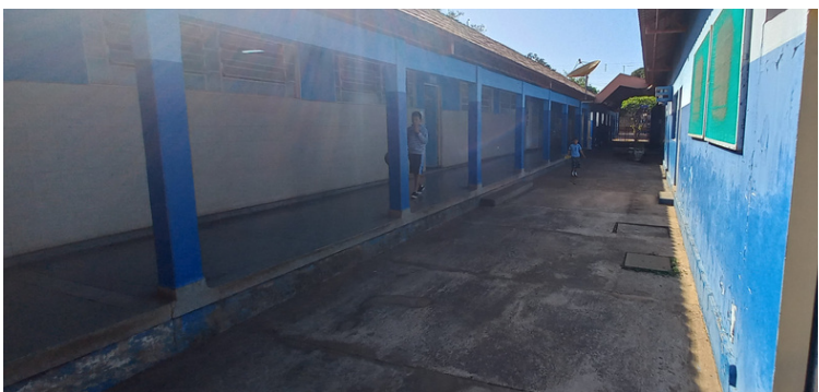
Foto 3 Pátio externo carecendo de revitalização da pintura das paredes.
