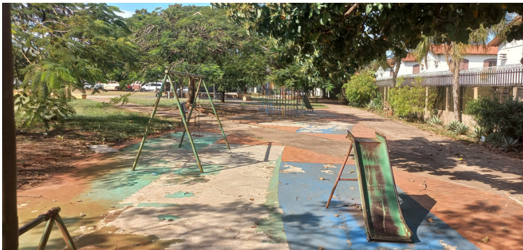
Foto 3 - Parquinho infantil necessitando de reforma e melhorias.
