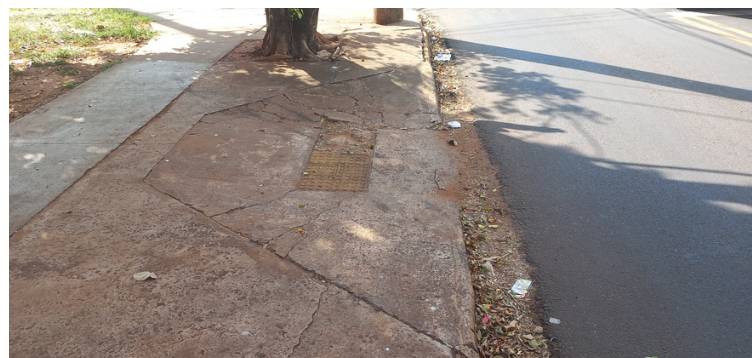
Foto 8 - Calçamento do espaço público constante de consideráveis rachaduras.
