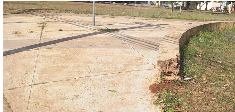
Foto 4 - Estrutura de concreto avariada.
