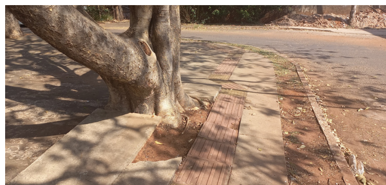
Foto 8 Calçamento da pista de caminhada danificado.
