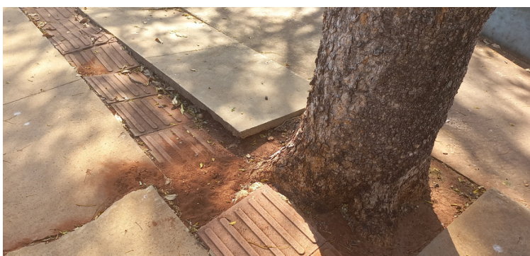
Foto 7 Piso tátil com desnível.
