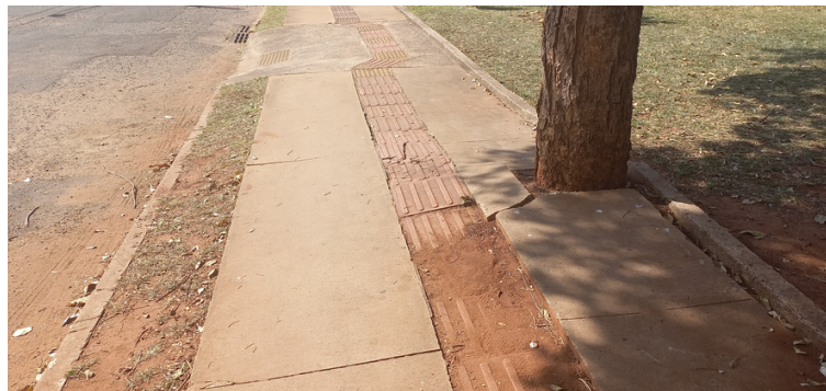
Foto 6 Calçada da pista de caminhada irregular.
