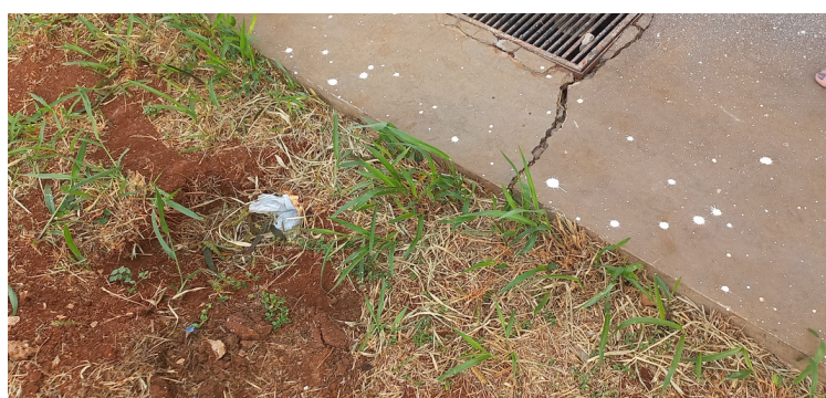
Foto 16 - Rede de esgotamento irregular.
