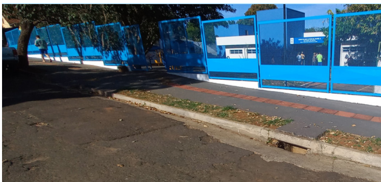
Foto 15 Bueiros transbordam nos dias de chuva.
