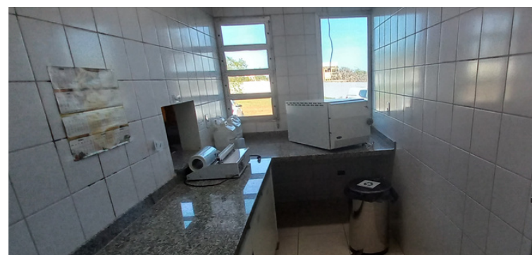
Foto 8 Sala de esterilização com autoclave estragada.
