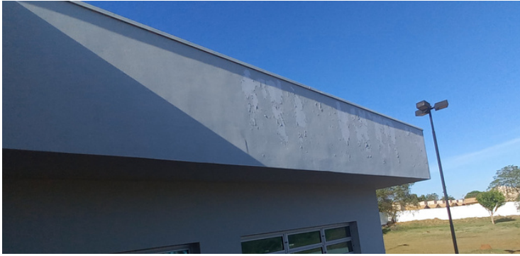
Foto 11 Paredes com infiltrações em alguns pontos.
