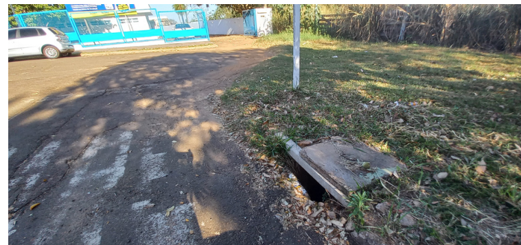
Foto16 Bueiros transbordam e atingem o estacionamento da unidade com dejetos.
