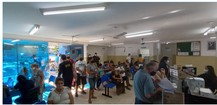
Foto 2 Recepção da unidade com número insuficiente de cadeiras para pacientes aguardarem atendimento e ventiladores quebrados.
