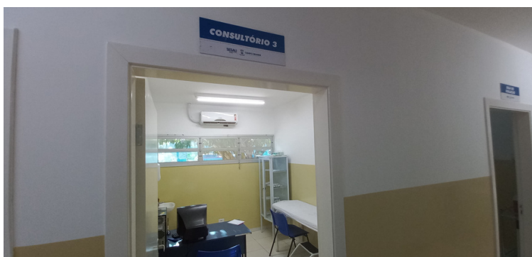
Foto 7 Consultório médico ar condicionado não funciona e sem ventilador.
