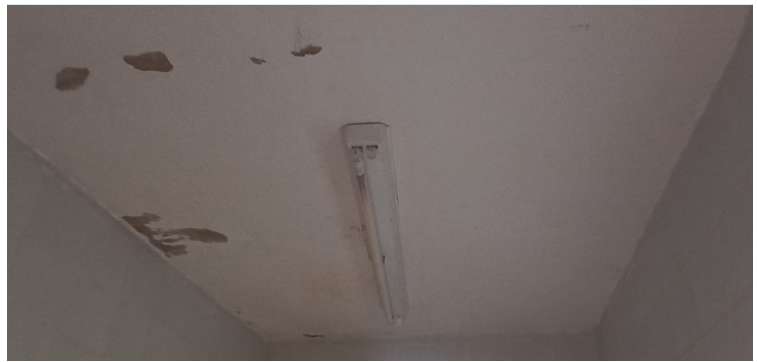
Foto 4 Teto do banheiro necessita de reparos e pintura.
