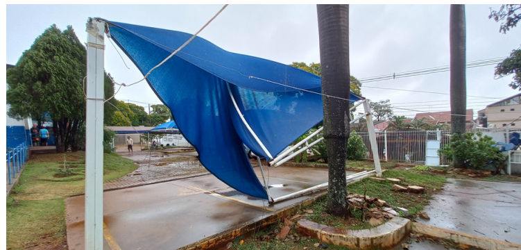
Foto 16 Toldo danificado por tempestade.
