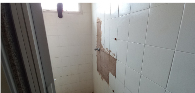
Foto 7 Azulejos, no banheiro, se desprendendo da parede.
