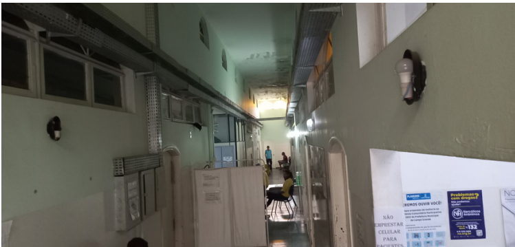
Foto 3 Iluminação precária por toda a extensão da unidade.
