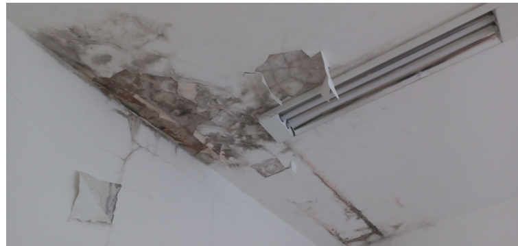
Foto 4 Telhado com irregularidades incorrendo em infiltrações.
