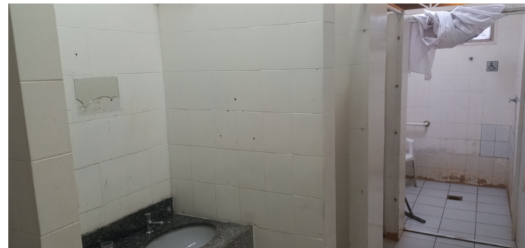
Foto 6 Banheiros necessitando de manutenção.
