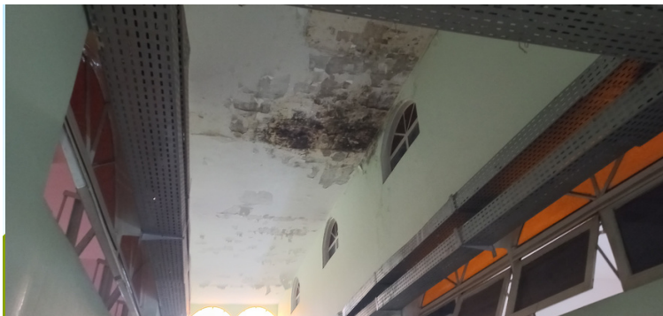
Foto 5 Excesso de mofo na paredes.
