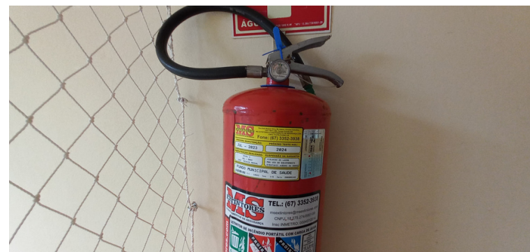
Foto 8 Extintores de incêndio dentro do prazo de validade.
