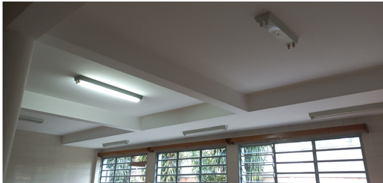
Foto 5 Lâmpadas da cozinha queimadas.
