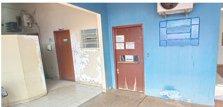
Foto 7 Paredes com pintura e portas carente de reforma.
