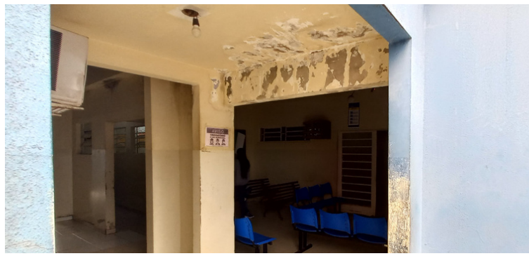
Foto 2 Corredor de entrada da unidade, com infiltrações e mofo nas paredes e teto.
