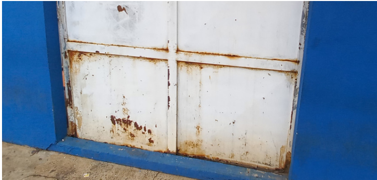
Foto 13 Portas externas enferrujadas e deterioradas.
