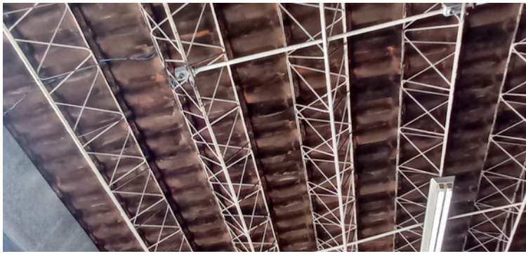
Foto 9 Telhado necessita de reforma urgentemente.
