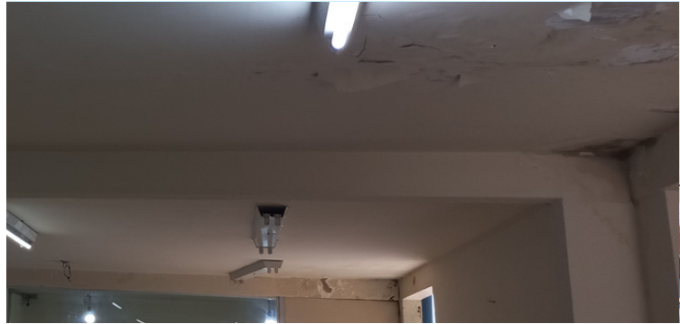
Foto 4 Corredor de espera com teto infiltrado, mofo e com lâmpadas faltantes.
