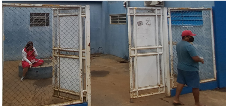
Foto 14 Portão com tela rompida e quebrado.
