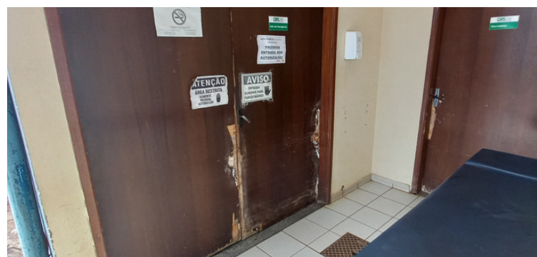
Foto 8 Portas das salas de atendimento muito deterioradas.
