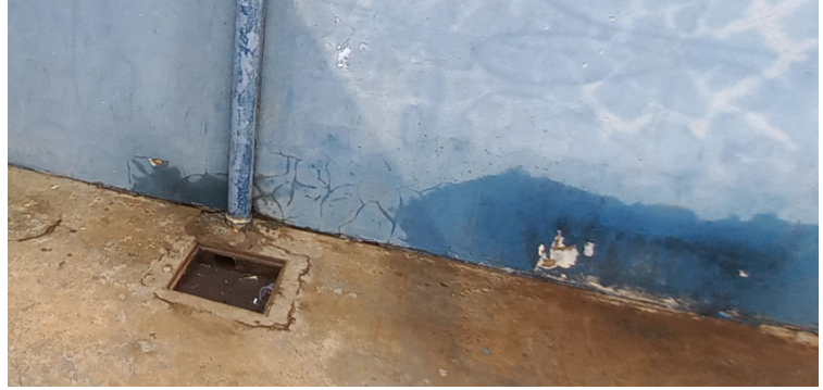
Foto 12 Ralo aberto e com tampa faltante.
