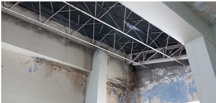
Foto 5 No corredor da unidade foi usada uma lona para tentar solucionar o problema de vazamento do telhado nos dias chuvosos.
