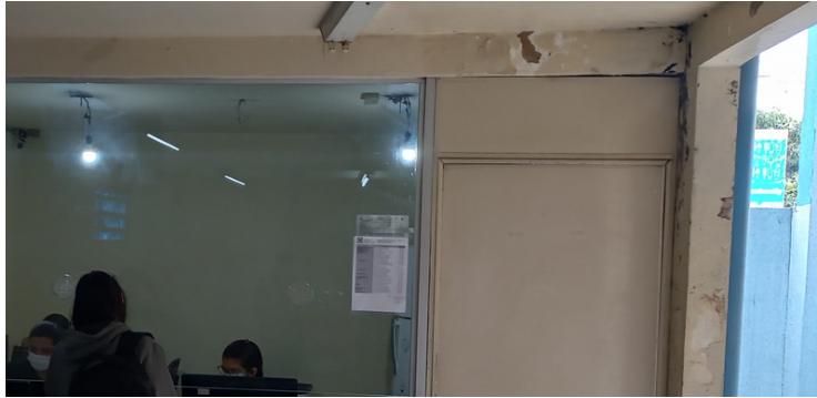
Foto 3 Recepção com paredes e teto infiltrados, mofo e com lâmpadas faltantes
