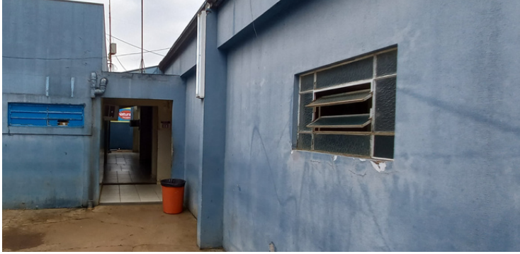
Foto 11 Paredes externas com pintura desgastadas e infiltradas.
