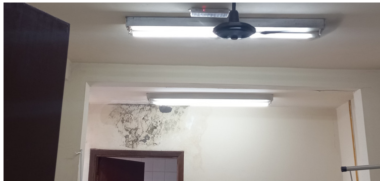
Foto 6 Sala de repouso com mofo e infiltrações nas paredes, e sem ar condicionado.
