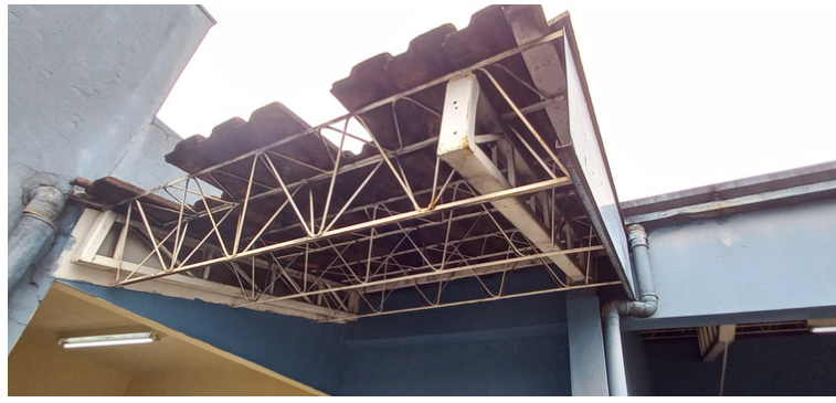
Foto 10 Telhado com problemas e telhas quebradas.
