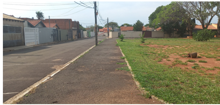
Foto 2 Pista de caminhada com alguns desníveis no calçamento.
