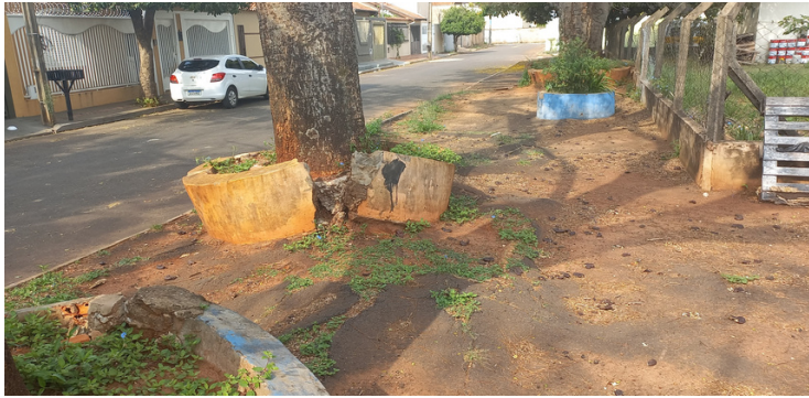
Foto 3 Pista de caminhada danificada pelas raízes das árvores.
