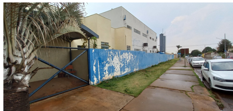
Foto 8 Paredes externas com pintura desgastada.
