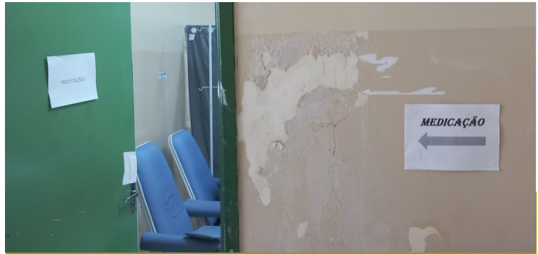
Foto 6 Paredes internas necessita de pintura.
