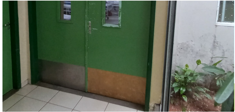
Foto 4 Portas carecendo de reparos da maçaneta e pintura.
