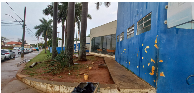
Foto 7 Paredes externas com pintura desgastada.
