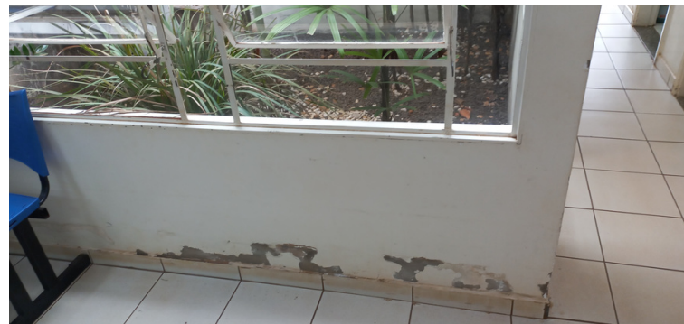
Foto 4 Determinados pontos da unidade com fissuras e pintura desgastada.
