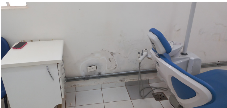
Foto 5 Setor de odontologia com focos de infiltração nas paredes.
