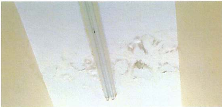
Foto 3 - Teto da unidade repleto de mofo
