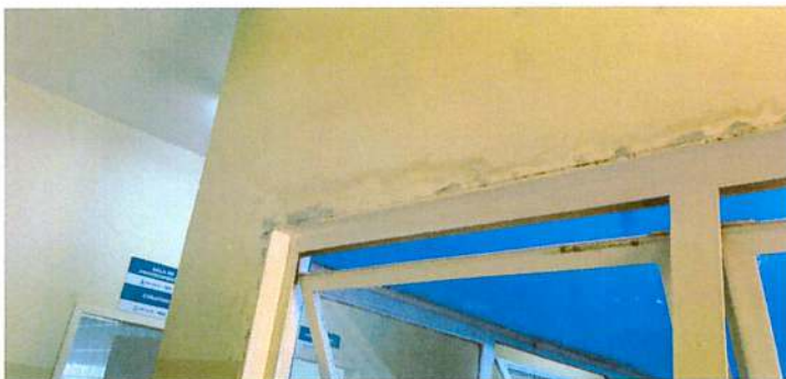
Foto 5 - Esquadrias avariadas devido à infiltrações
