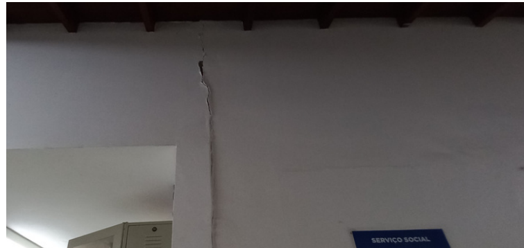
Foto 4 - Rachaduras ocorrem em locais pontuais da unidade.
