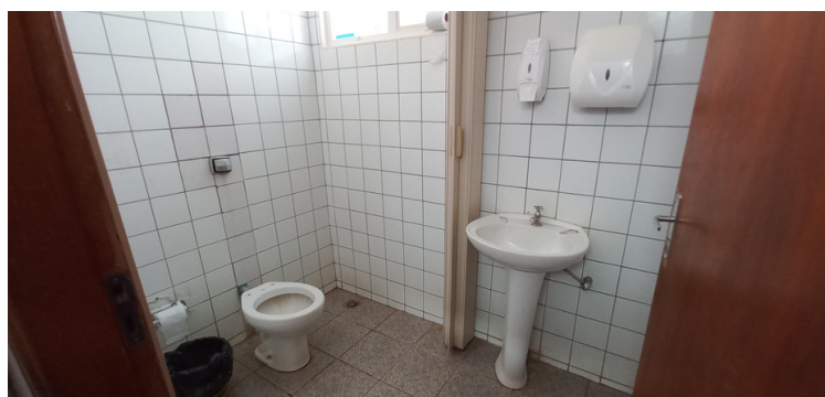
Foto 10 - Ausência de banheiro para uso de PCD's.
