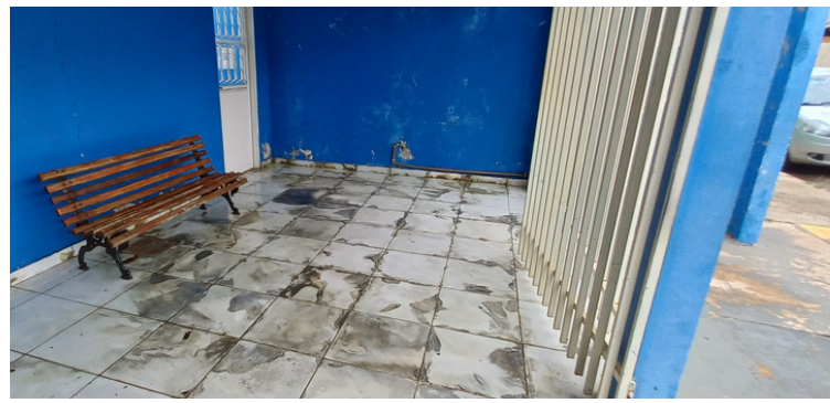
Foto 2 - Piso da área frontal mofado.
