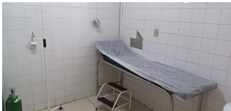
Foto 6 - Sala de curativo com azulejos se desprendendo e ausência de climatização.
