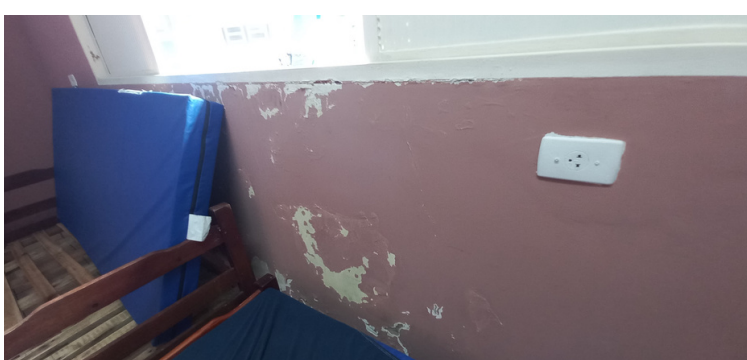
Foto 8 - Dependência para repouso de servidores, repleta de mofo e infiltração.
