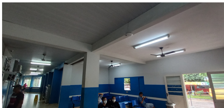
Foto 2 - Recepção desprovida de adequada climatização.
