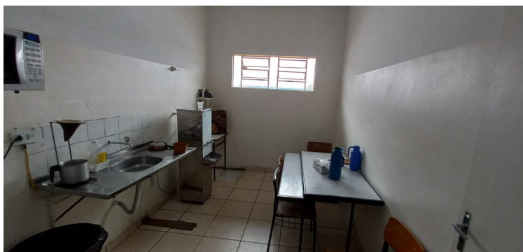
Foto 10 - Copa pouco iluminada, com ausência de alguns pisos e o mobiliário deteriorado.
