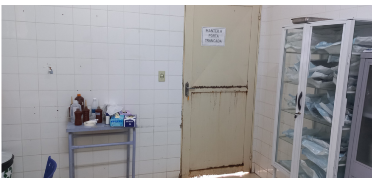
Foto 7 - Porta da sala de curativo, corroída pela ferrugem.
