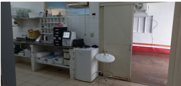
Foto 5 - Sala de emergência com a porta enferrujada e sem eletrocardiograma.
