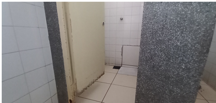
Foto 9 - Sanitários com portas deterioradas e hidras estragadas.
