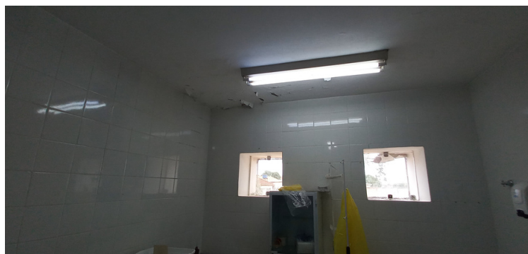
Foto 6 - Consultório desativado devido à infiltrações, janela quebrada e vazamento de água pluvial pela luminária.
