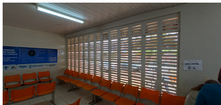
Foto 3 - Janela localizada na recepção que permite a entrada de água pluvial.
