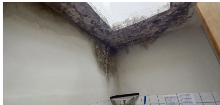
Foto 14 - Setor de limpeza repleto de mofo.
