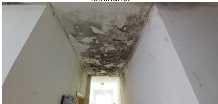
Foto 8 - Proliferação expressiva de mofo em determinados locais da unidade.
