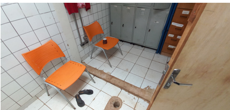
Foto 15 - Depósito de material de limpeza com o ralo sem a devida proteção.
