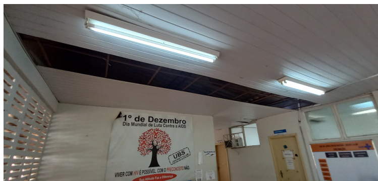
Foto 5 - Forro instalado na recepção com a estrutura danificada.
