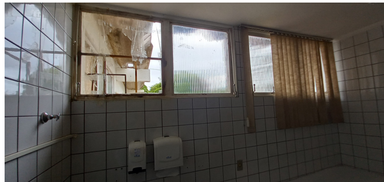
Foto 12- Consultório isento de equipamento de refrigeração e janela quebrada.
