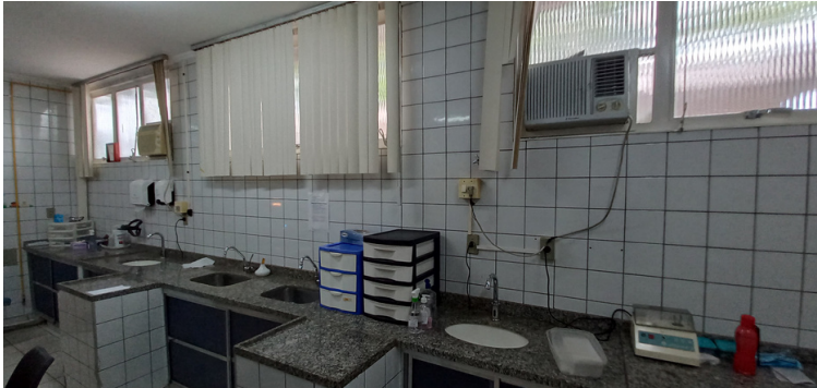
Foto 11 - Sala de odontologia com climatização insuficiente devido a impotência do ar condicionado.
