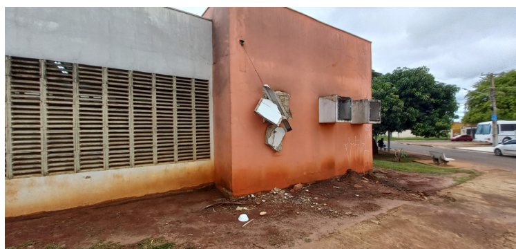
Foto 2 - Estrutura avariada em função da queda de árvore .
