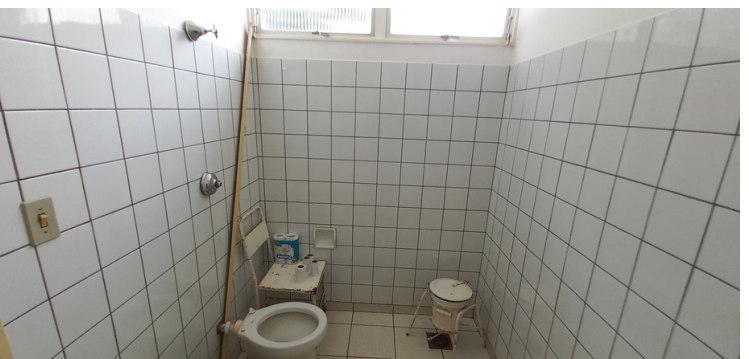
Foto 13- Banheiros sem manutenção e sem acessibilidade.
