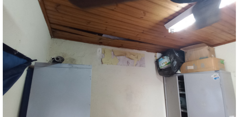
Foto 4 - Sala dos ACS em péssimas condições.
