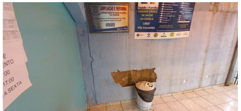
Foto 8 - Pintura externa carecendo de revitalização.
