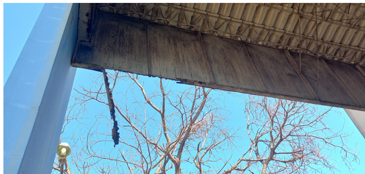
Foto 8 - Cobertura metálica deteriorada.
