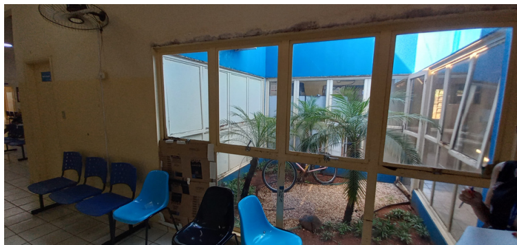
Foto 3 - Esquadrias de portas e janelas corroídas pela ferrugem.
