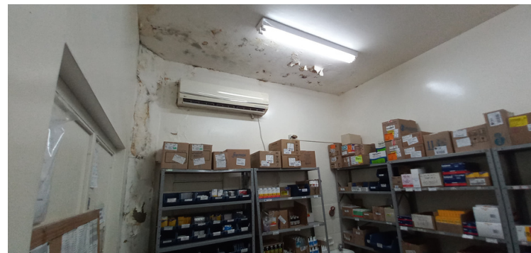
Foto 4 - Farmácia acometida severamente por infiltração e mofo.
