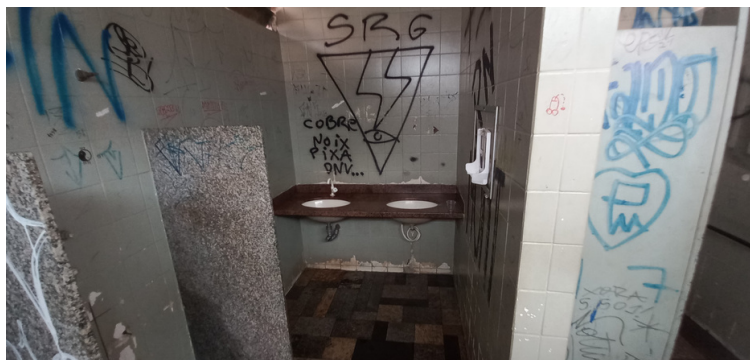
Foto 9 - Banheiro masculino completamente depredado.
