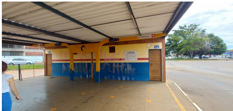
Foto 11 - Pichações por toda a extensão do terminal.
