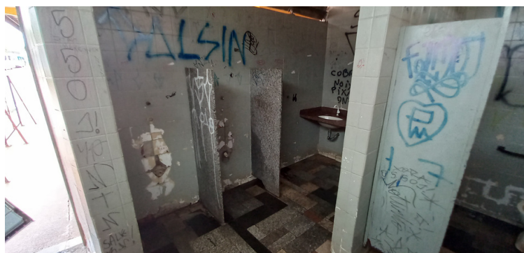
Foto 10 - Sanitário destituído de mictórios.
