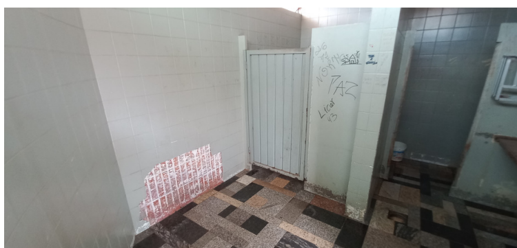
Foto 7 - Banheiro feminino sem as mínimas condições de higiene.
