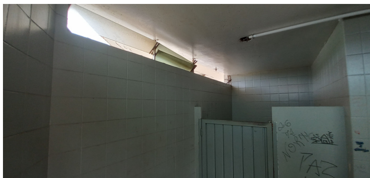
Foto 8 - Vidros quebradas e paredes danificadas nos sanitários.
