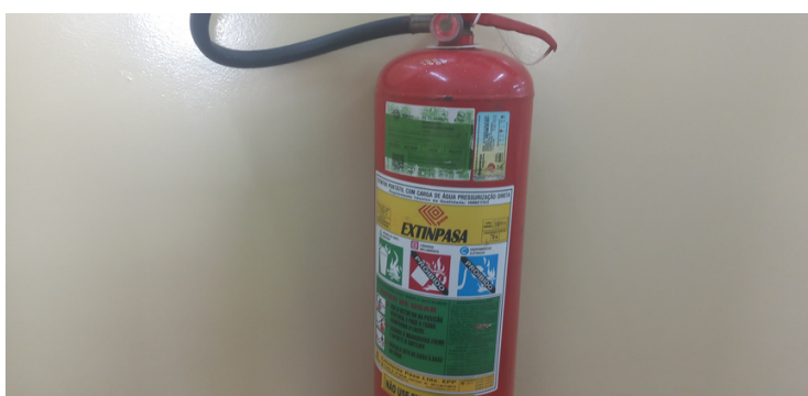
Foto 7 - Extintores com data expirada, esperando recarga.
