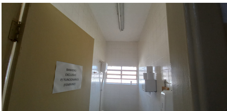
Foto 5 - A repartição carece de revisão na rede elétrica.
