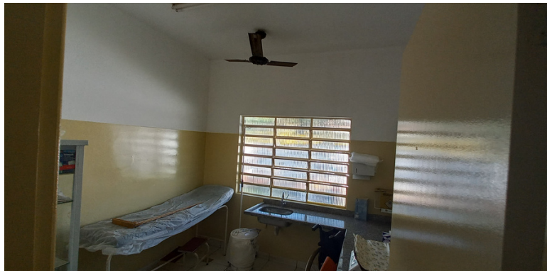
Foto 4 - Falta de apropriado sistema de climatização na unidade.
