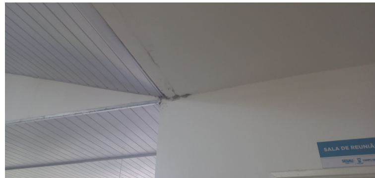
Foto 4 - Resquícios de antigas infiltrações no forro da recepção.
