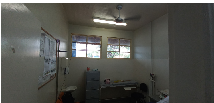
Foto 7 - Determinadas salas e consultórios, deficientes quanto à climatização.
