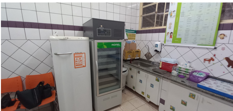
Foto 5 - Câmara fria avariada.
