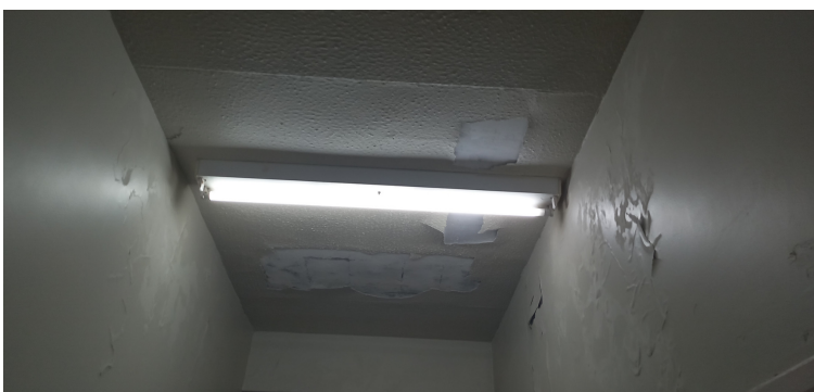
Foto 3 - Pintura recém realizada com danos devido a infiltrações.
