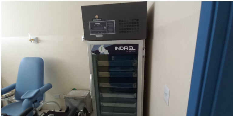
Foto 4 - Câmara fria da sala de vacina que aguarda reparo.
