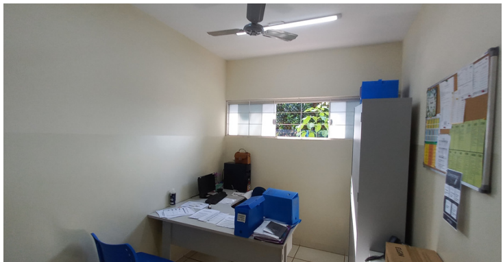
Foto 3 - Unidade que necessita de readequação da climatização.
