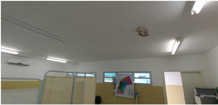
Foto 5 - Locais pontuais com mofo evidente.
