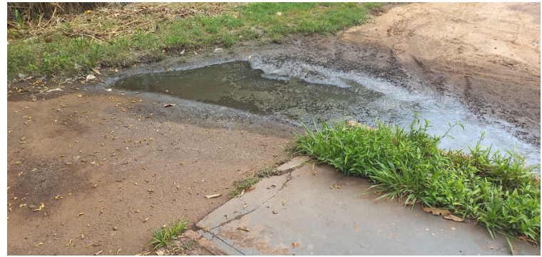
Foto 6 - Bueiro em frente a repartição com dejetos humanos.
