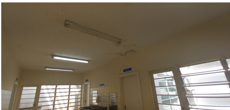
Foto 7 - Corredor pintura desgastada, com infiltração e mofo.
