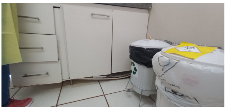
Foto 8 - Sala de coleta com armário avariado.
