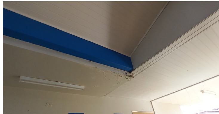
Foto 3 - Recepção com infiltração e mofo.
