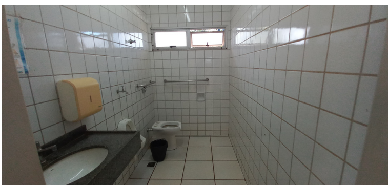
Foto 7 - Banheiro destinado ao público em geral com vaso sem tampa.
