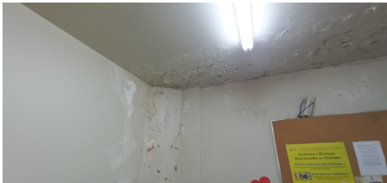
Foto 6 - Sala multiuso com paredes com pintura desgastada e bolor.
