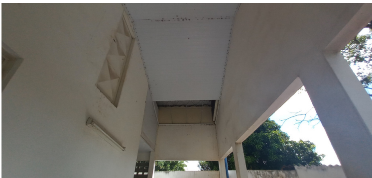
Foto 7- Estrutura do forro danificada.
