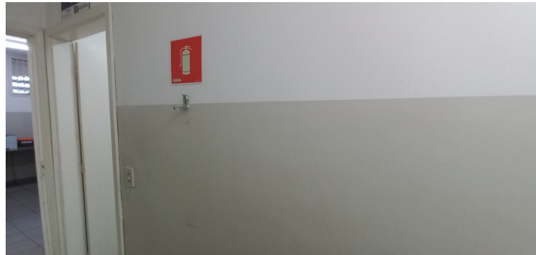
Foto 6 - Ausência de extintores em locais pontuais da unidade.
