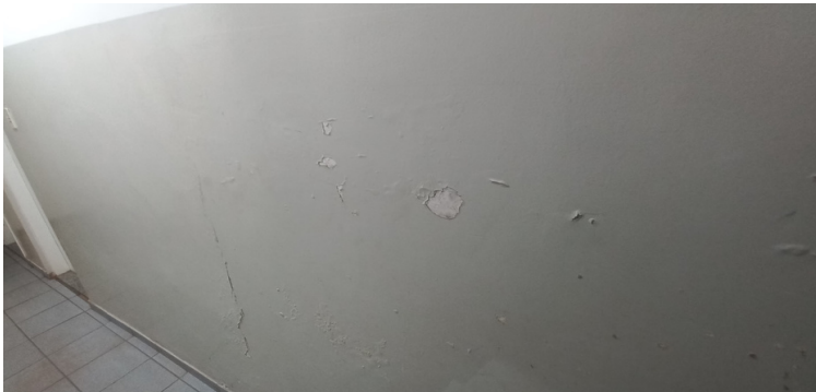
Foto 5 - Pintura externa e interna desgastada.
