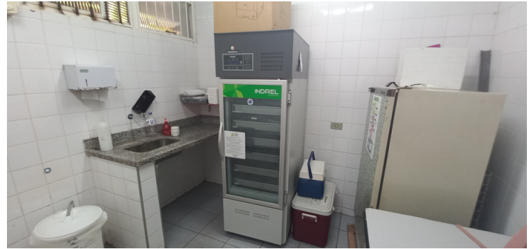
Foto 4 - Câmara fria avariada.
