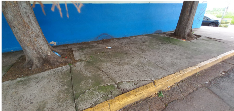
Foto 13 - Calçada de passeio comprometida.
