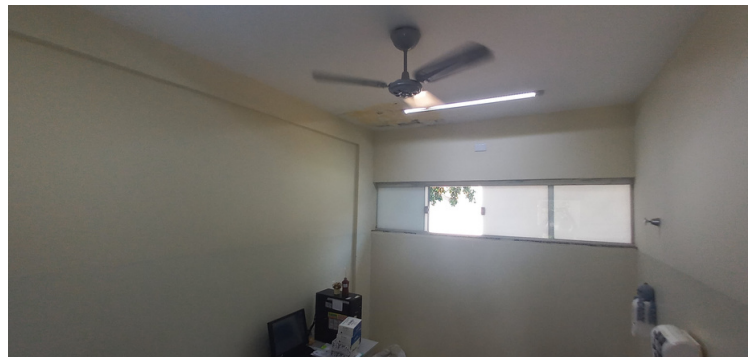
Foto 5 - Sala da enfermagem sem a adequada climatização.
