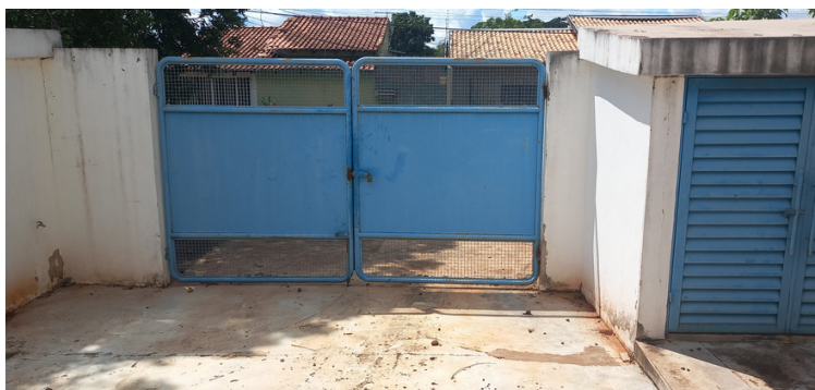
Foto 7- Portão de acesso ao estacionamento quebrado.
