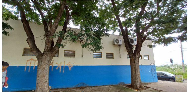
Foto 12 - Árvores vultosas comprometendo a calçada.
