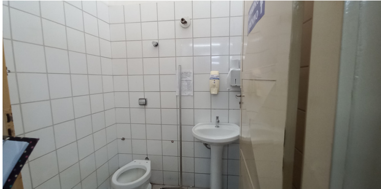
Foto 11 - Banheiro dos servidores sem lâmpadas e vaso sem tampa.
