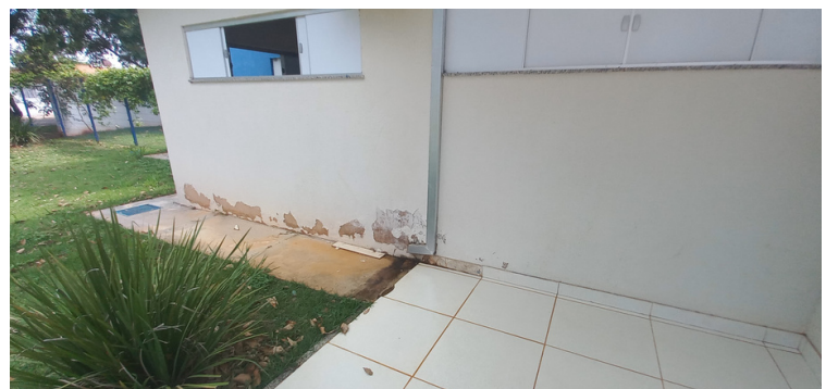
Foto 8 - Fachada externa necessitando de uma revitalização.
