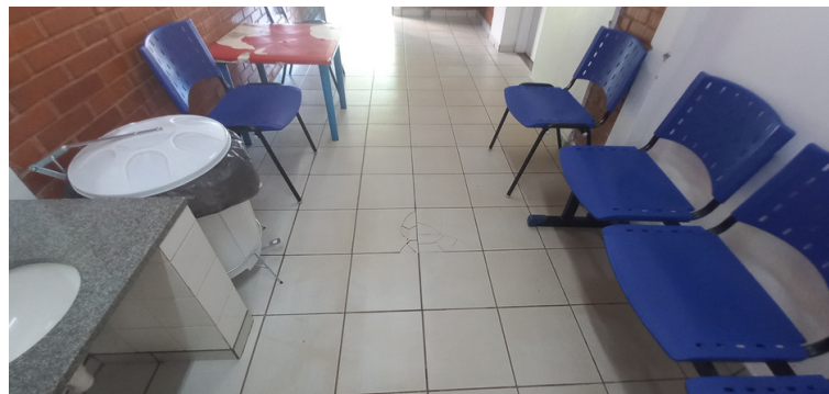
Foto 6 - Assoalho trincado desnivelando a estrutura do piso.
