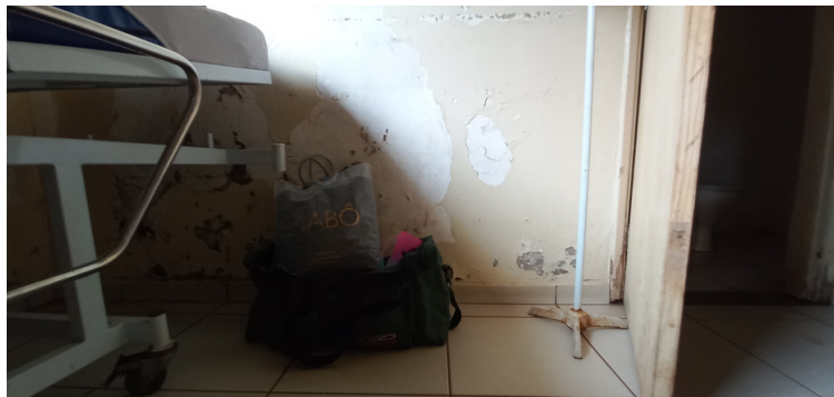
Foto 3 - Parte da estrutura do CRS apresenta infiltrações e mofo.
