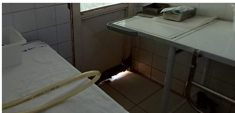
Foto 5 - Portas corroídas pela ferrugem.
