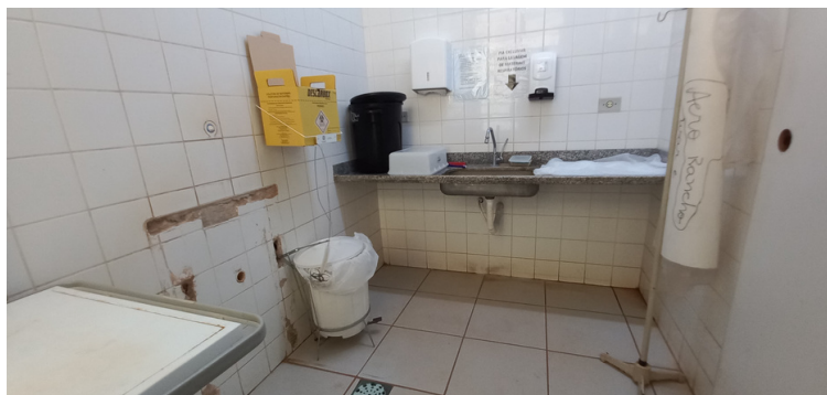
Foto 17 - Setor de esterilização sem a devida separação, possibilitando o cruzamento de materiais esterilizados e os infectados.
