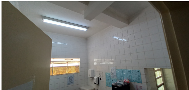
Foto 19 - Sala de esterilização isenta de climatização adequada.
