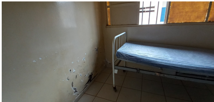
Foto 11 - Sala de repouso com infiltrações e cama sem grade de proteção.
