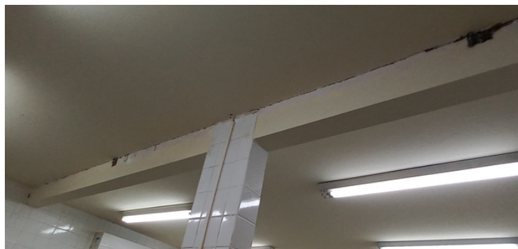
Foto 2 - Rachaduras atingindo locais pontuais da unidade.
