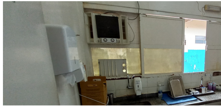
Foto 6 - Ares condicionados obsoletos, ineficazes da adequada climatização.
