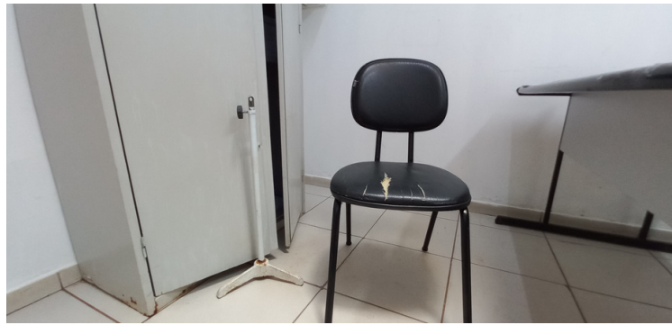
Foto 14 - Armários sem fechamentos, enferrujados e cadeiras desgastadas.
