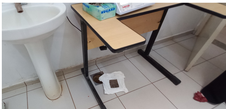
Foto 13 - Ralos localizados nos consultórios sem tampa de proteção, exalando forte odor fétido.
