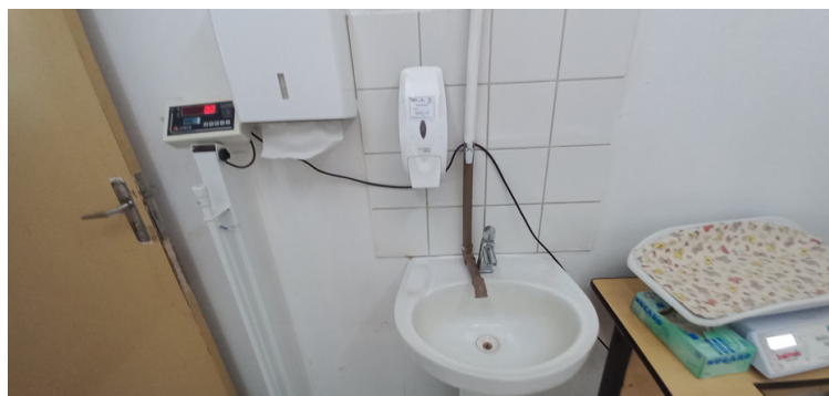
Foto 16 - Tubulação irregularmente instalada para sanar vazamento de água no ar condicionado.
