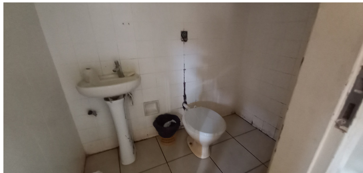
Foto 12 - Banheiro interditado em uma das salas de repouso.
