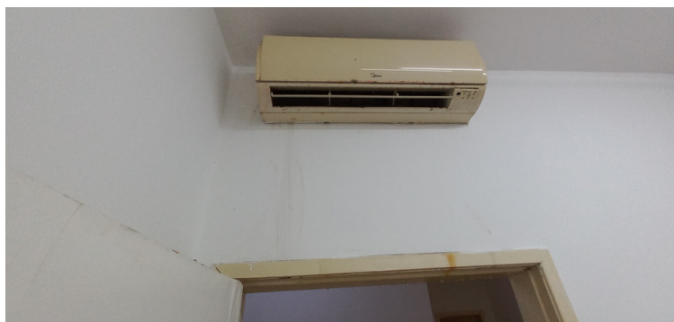
Foto 15 - Vazamento de água ocorrendo em alguns ares condicionados.
