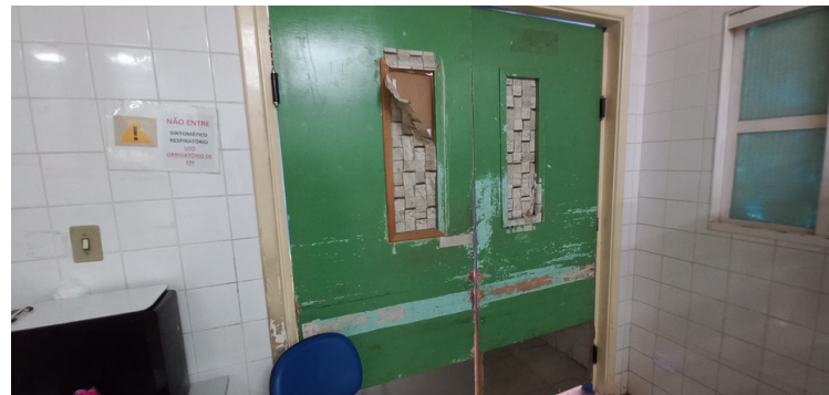
Foto 4 - Vidros de janelas e portas estão quebrados.
