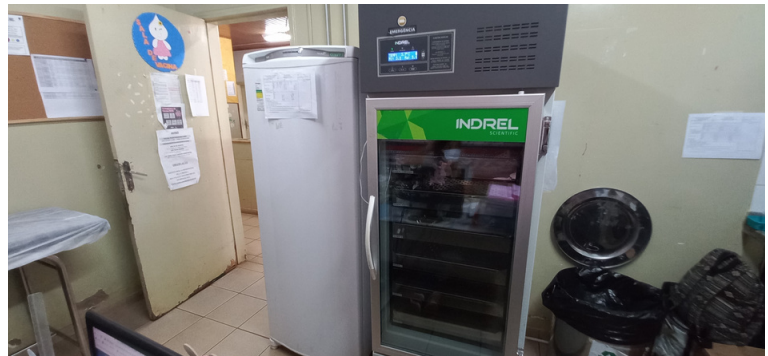
Foto 6 - Sala de vacinas com câmara fria estragada.
