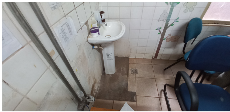
Foto 9 - Sala de triagem com ralo aberto e azulejos faltantes.
