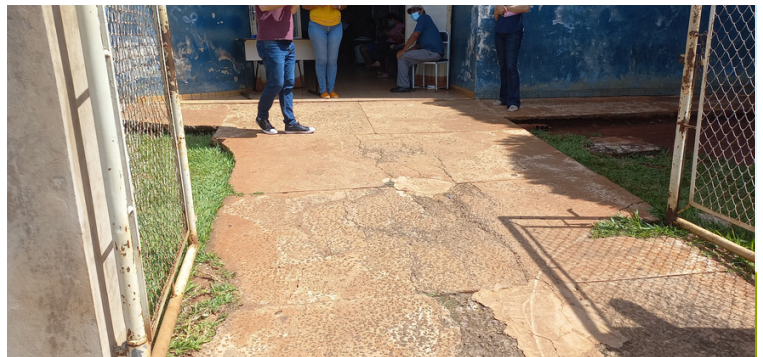
Foto 14 - A unidade não oferece acessibilidade apropriada.
