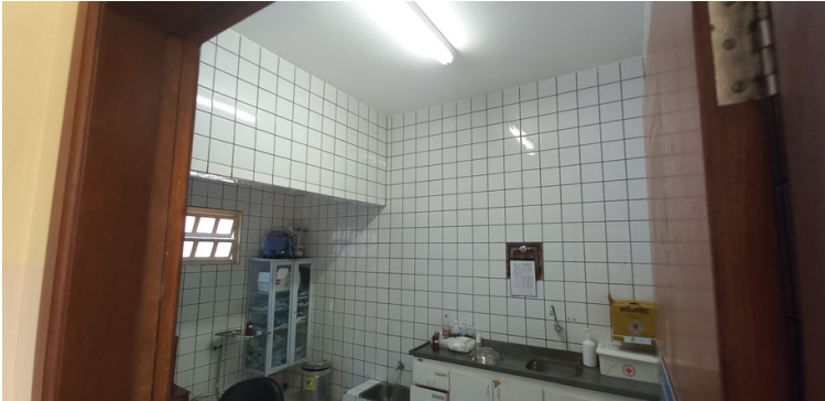
Foto 3 - Sala de vacinas com lâmpadas queimadas.
