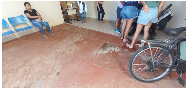
Foto 10 - Falta de acessibilidade adequada.
