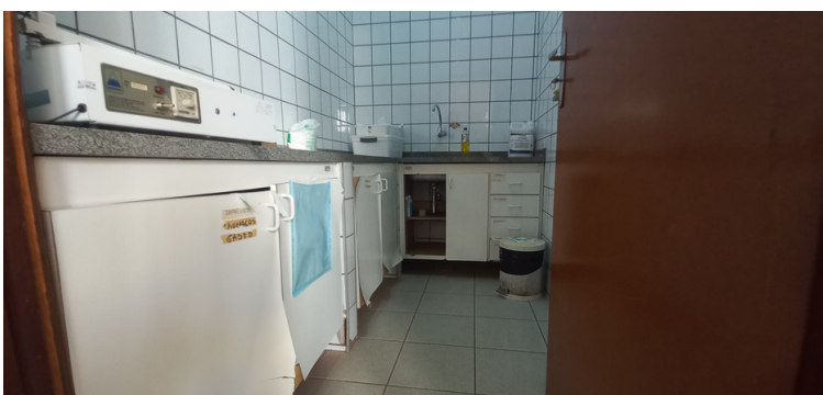
Foto 7 - Setor de esterilização com móveis danificados.
