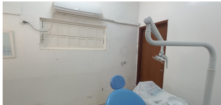
Foto 6 - Setor de Odontologia com paredes com pintura desgastada.
