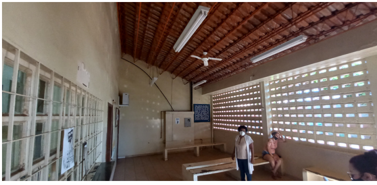
Foto 9 - Setor de acolhimento com lâmpadas queimadas.
