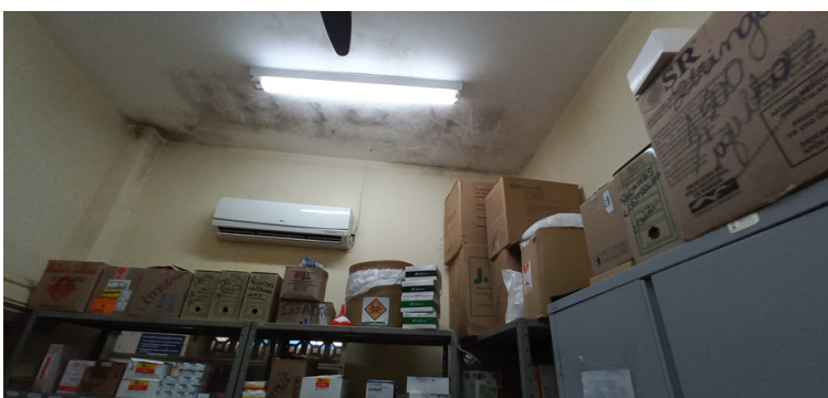
Foto 7 - Farmácia com infiltração e bolor evidente.
