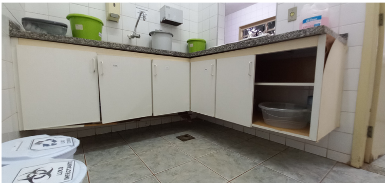
Foto 5 - Setor de esterilização com armários avariados.
