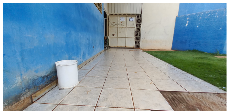
Foto 8 - Entrada da unidade com falta de acessibilidade e piso quebrado.
