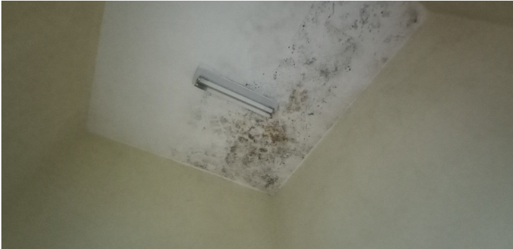
Foto 3 - Setor de Odontologia com infiltração e mofo aparentes.
