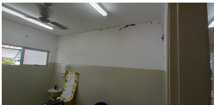
Foto 7 - Sala do serviço social com rachaduras evidentes.
