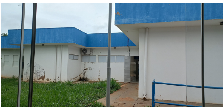
Foto 8 - Fachada externa carecendo de revitalização.
