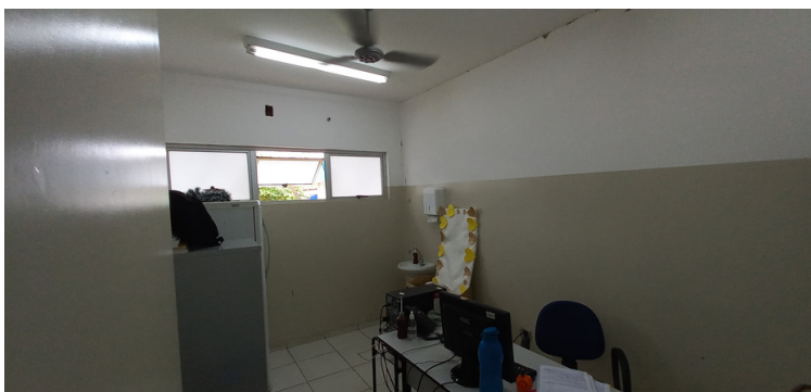
Foto 6 - Sala do serviço social sem a apropriada refrigeração.
