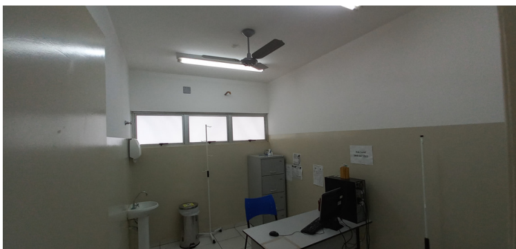
Foto 4 - Consultório sem a climatização adequada.
