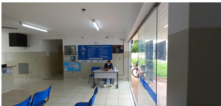
Foto 2 - Recepção sem a devida climatização.
