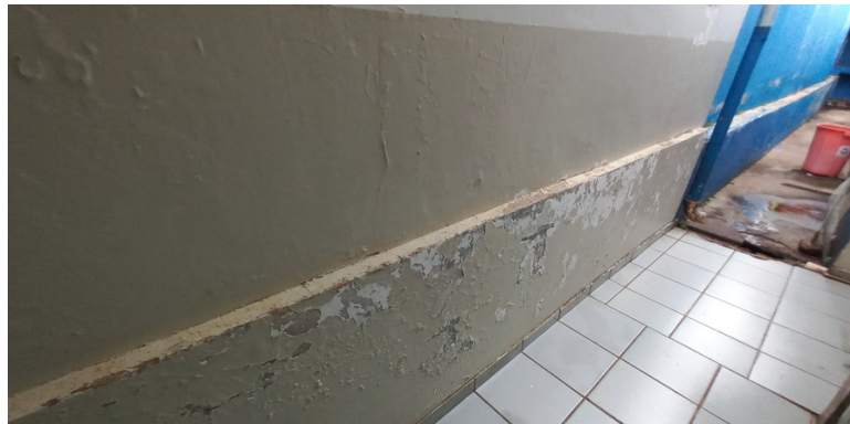
Foto 4 - Pintura da unidade desgastada.
