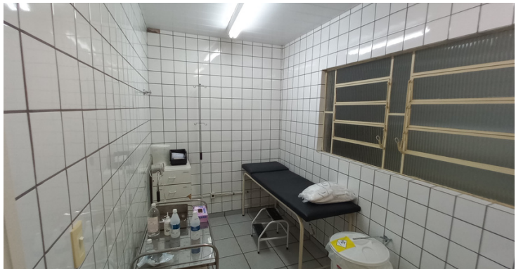
Foto 3 - Sala de curativo sem refrigeração apropriada e com azulejos caídos.
