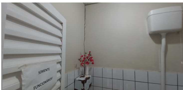
Foto 7 - Banheiro de uso dos funcionários com rachadura visível.
