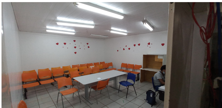
Foto 5 - Sala de reunião com lâmpadas faltantes.
