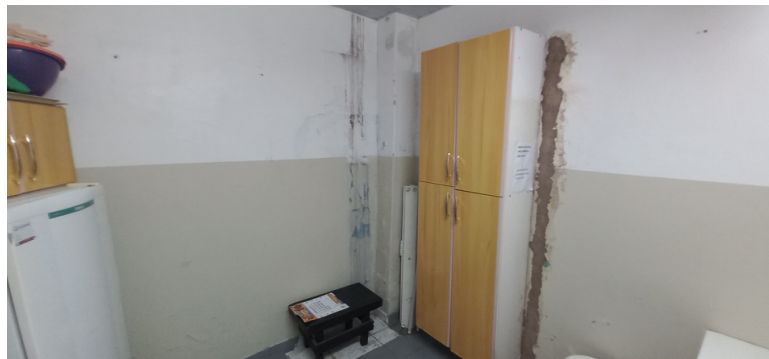
Foto 6 - Copa com infiltração e bolor evidentes.
