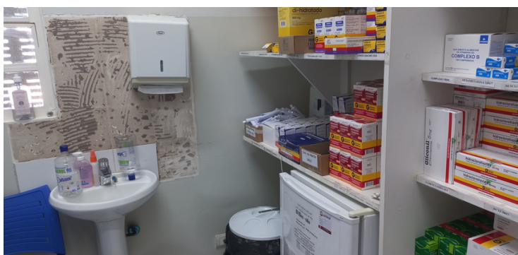
Foto 7 - Farmácia com azulejos caídos.
