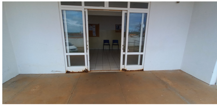
Foto 2 - Porta de acesso à unidade enferrujada.
