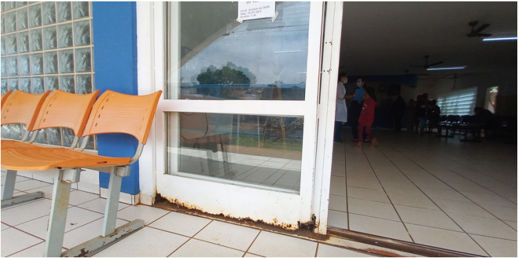
Foto 3 - Porta de acesso à recepção da unidade mal encaixada.
