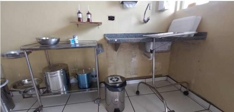
Foto 5 - Sala de curativo com pintura desgastada e com infiltração.
