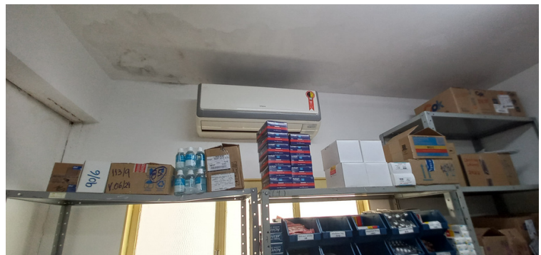
Foto 8 - Farmácia com o teto mofado e com infiltração.
