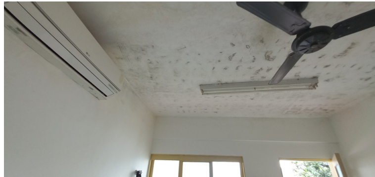
Foto 6 - Sala de curativo desativada, devido a presença de mofo no teto.
