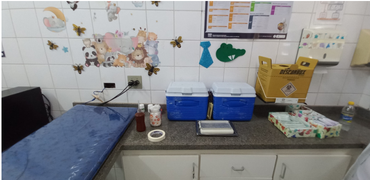
Foto 3 - Sala de vacina com caixas térmicas avariadas.
