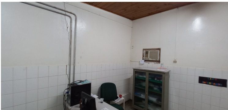
Foto 5 - Consultório médico com rachadura visível.
