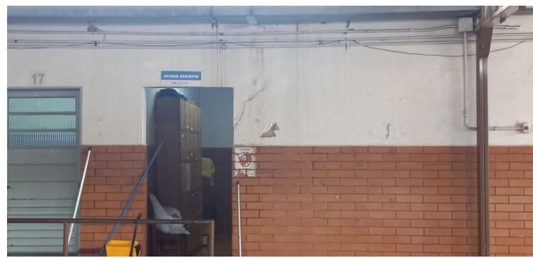
Foto 2 - Paredes da unidade com rachaduras aparentes.
