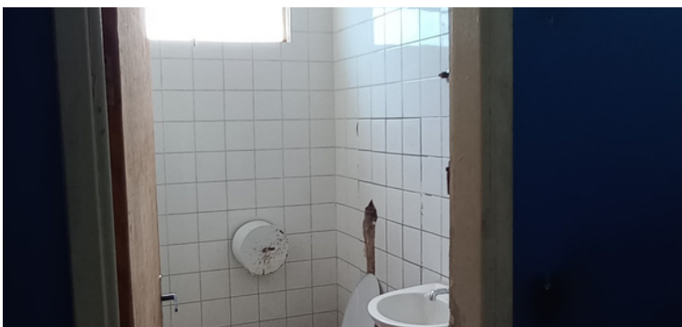
Foto 7 - Banheiro para usuários com equipamentos enferrujados.
