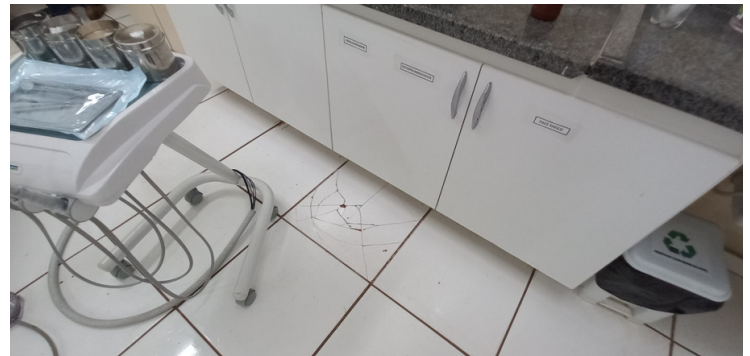
Foto 4 - Setor de Odontologia, com estufamento do piso.
