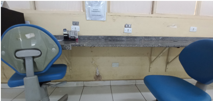
Foto 5 - Setor de Odontologia com paredes desgastadas e mofadas.
