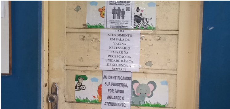
Foto 3 - Porta da sala de vacina, com pintura descascada e ferrugem.
