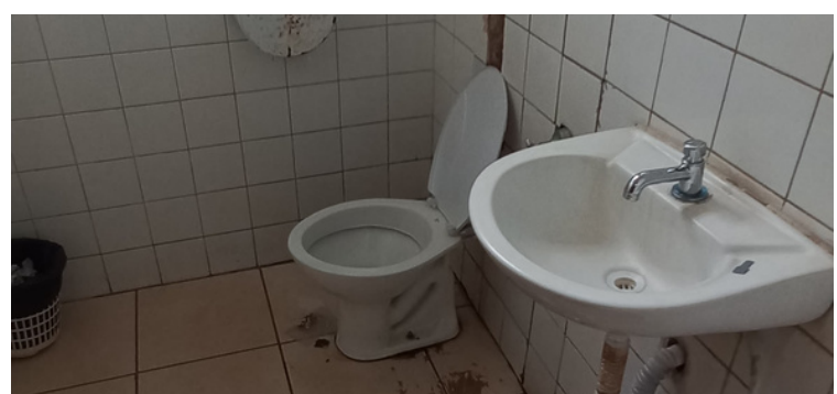
Foto 8 - Banheiro para uso da população com azulejos quebrados e falta de reparos.
