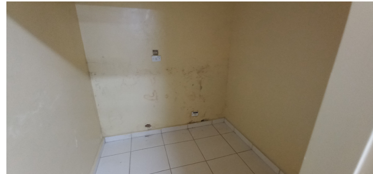
Foto 6 - Sala de raio-x anexa ao setor de Odontologia com infiltração e mofo.
