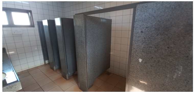
Foto 4 - Banheiro de uso público com falta de porta.
