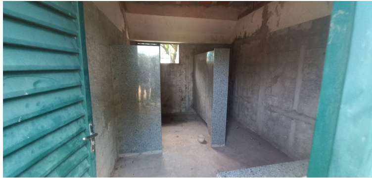
Foto 3 - Sanitários interditados devido a obra suspensa.
