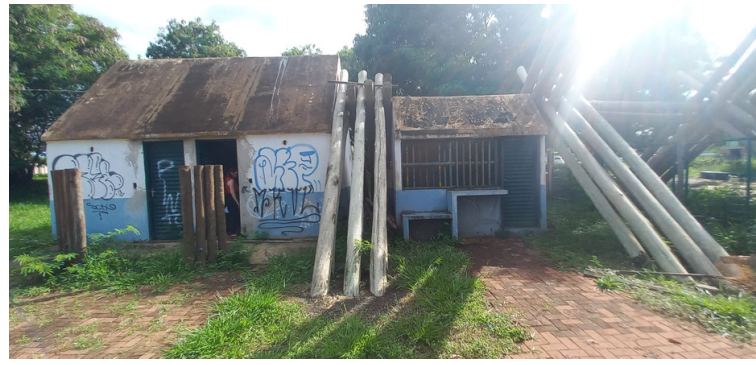
Foto 2 - Banheiros das entradas secundárias com obras inacabadas.
