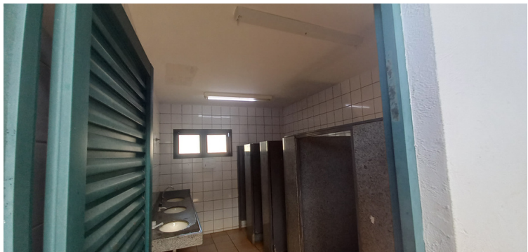
Foto 5 - Lâmpadas queimadas necessitando de substituição, nos sanitários.
