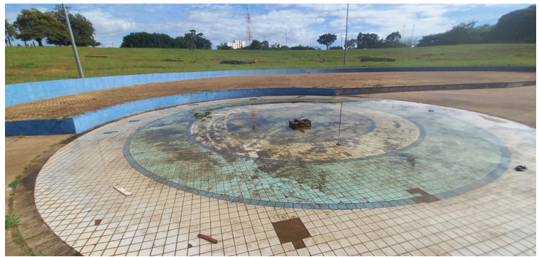
Foto 12 - Espelho d'água com obra inacabada e acúmulo de água.
