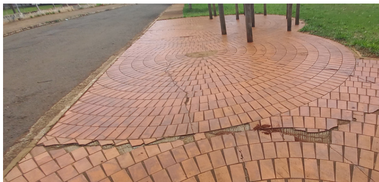
Foto 2 - Calçamento com lajotas se desprendendo.
