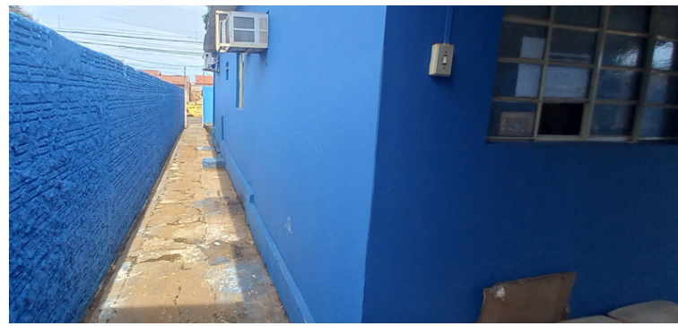
Foto 4 - Vidro que necessita de reposição.
