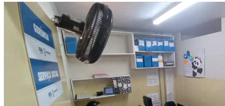
Foto 8 - Falta climatização adequada na unidade.
