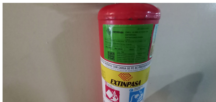
Foto 8 - Extintores com a data de validade vencida.
