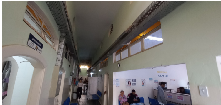
Foto 3 - Unidade escassa de iluminação adequada.
