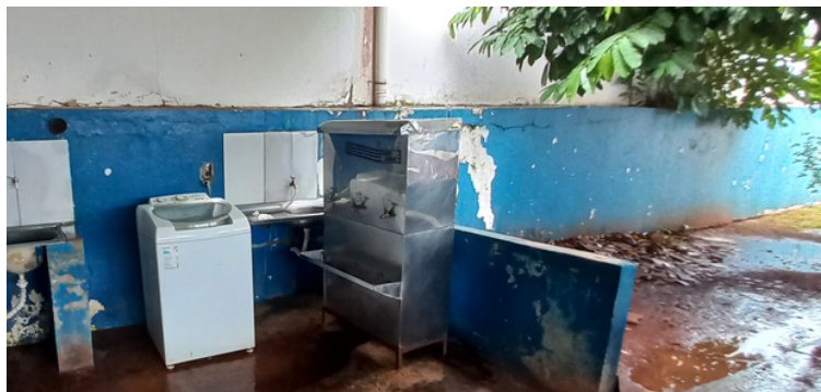
Foto 5 - Bebedouros avariados, sem a devida funcionalidade.
